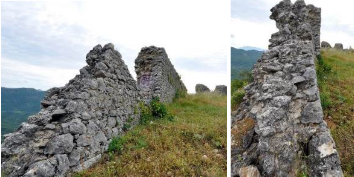
Εικ. 17α&β Ανατολικό άκρο θόρειας (Β) πλευράς με έντονη παθολογία: ανατροπή τμήματος, αποκόλληση, απόκλιση από την κατακόρυφο και ρηγματώσεις.
