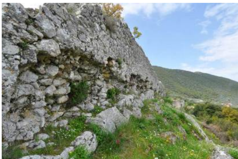
Εικ. 16 Βόρεια (Β) εξωτερική πλευρά στο δυτικό της άκρο, όπου παρουσιάζεται εκτεταμένη απώλεια λίθων.
