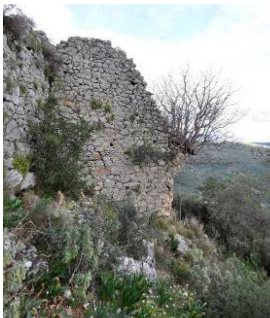
Εικ. 15 Τετράγωνος πύργος στη βορειοανατολική (ΒΑ) γωνία: εξωτερική άποψη. Ρηγματώσεις και αποδιοργάνωση λιθοδομής.
