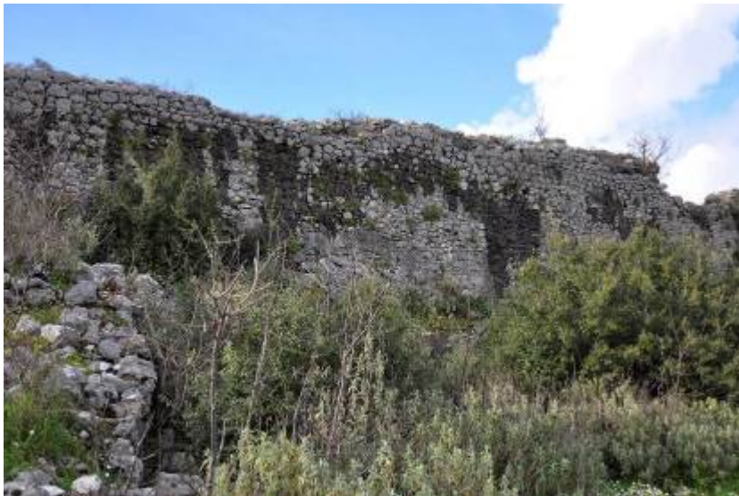
Εικ. 9 Νοτιοανατολική (ΝΑ) εξωτερική πλευρά με κύρια προβλήματα την απώλεια κονιάματος και απώλεια λίθων στη βάση έδρασης.
